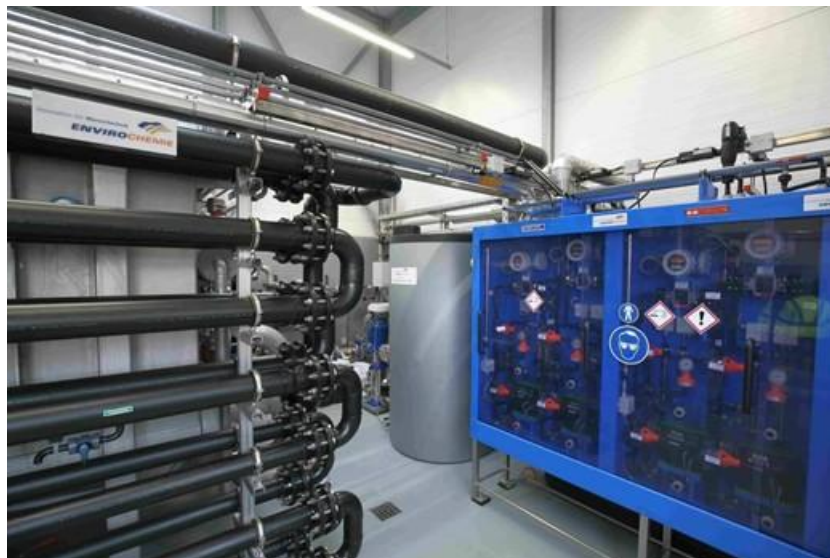
Slika 23. Izgled hemijskog bloka postrojenja za prečišćavanje otpadnih voda sa cevastim flokulatorom i merno-dozirnim stanicama
