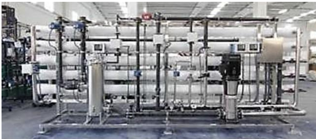
Slika 19. Izgled industrijskog postrojenja za reverznu osmozu RO1 na zajedničkom ramu sa pratećom opremom
